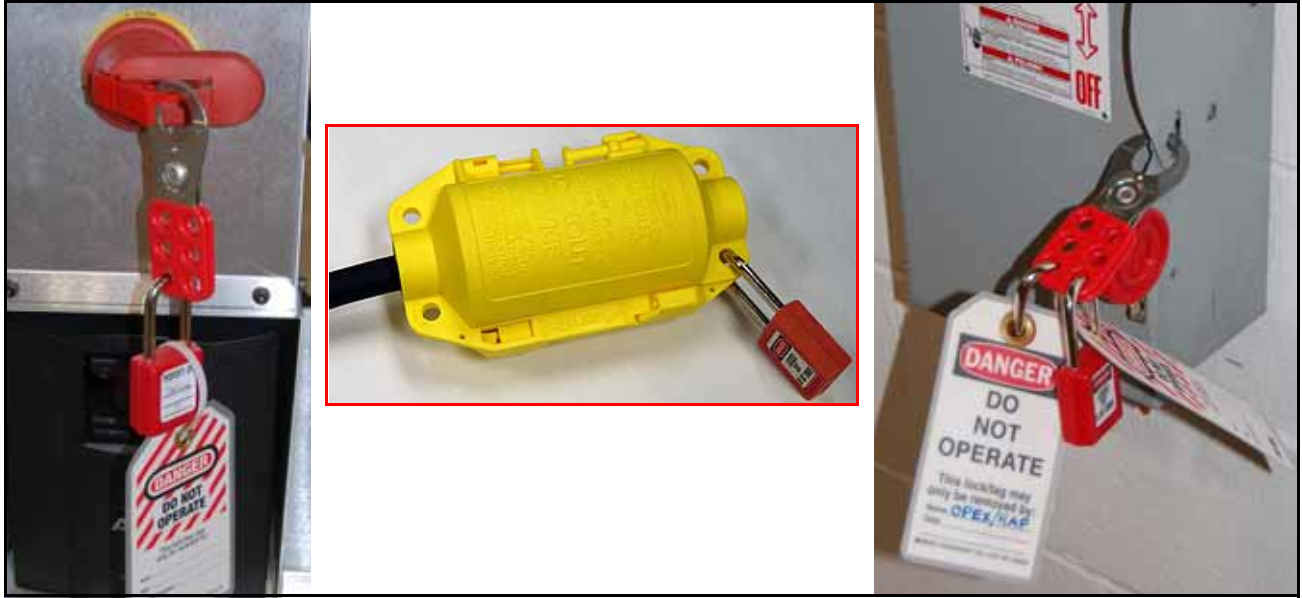
Figure 2-9: Ejemplos de Dispositivos LOTO Instalados
