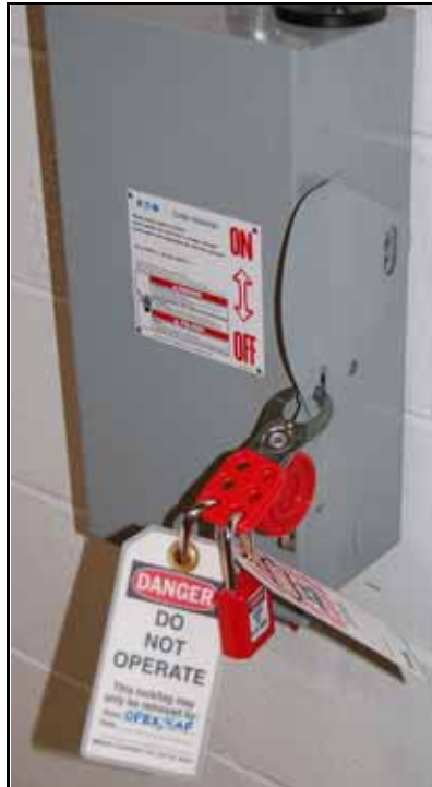
Bild 2-17: Beispiel- AC-Hauptschalter mit Lockout/Tagout
