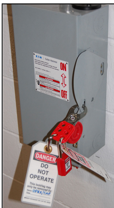
図 2-17: 例 – ロックアウト/タグアウトで AC 主電源を切断
