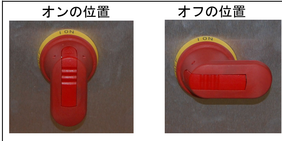
図 2-13: 主電源断路器ハンドル
