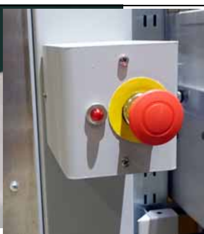
リターンコンベア奥の E-ストップボタン
