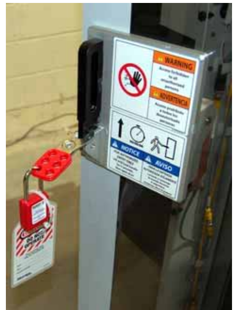
権限のある従業員により、ドアラッチにハスプ、ロック、タグが挿入された状態
