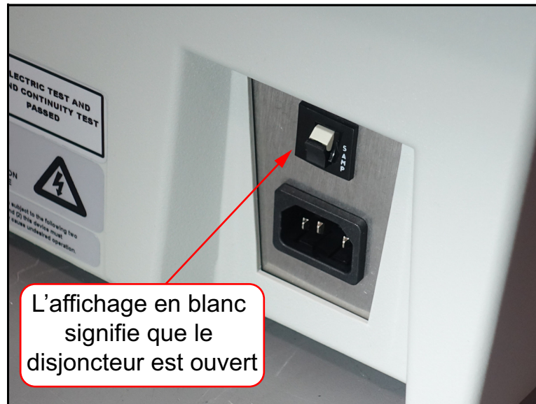
Figure 4-21 : Ouverture du disjoncteur
